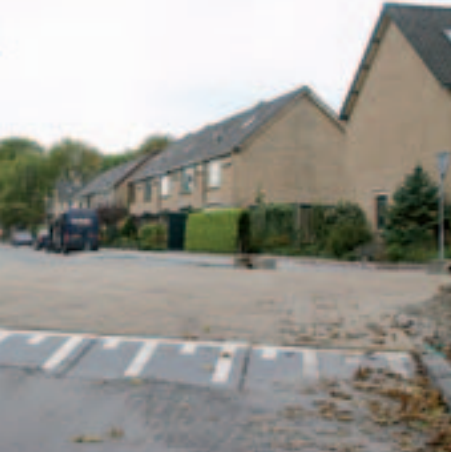
Duomix onder verkeersdrempels
